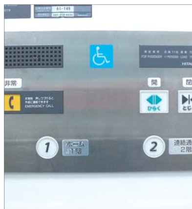
エレベーター点字標示板
