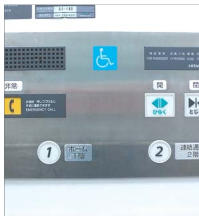
エレベーター点字標示板
